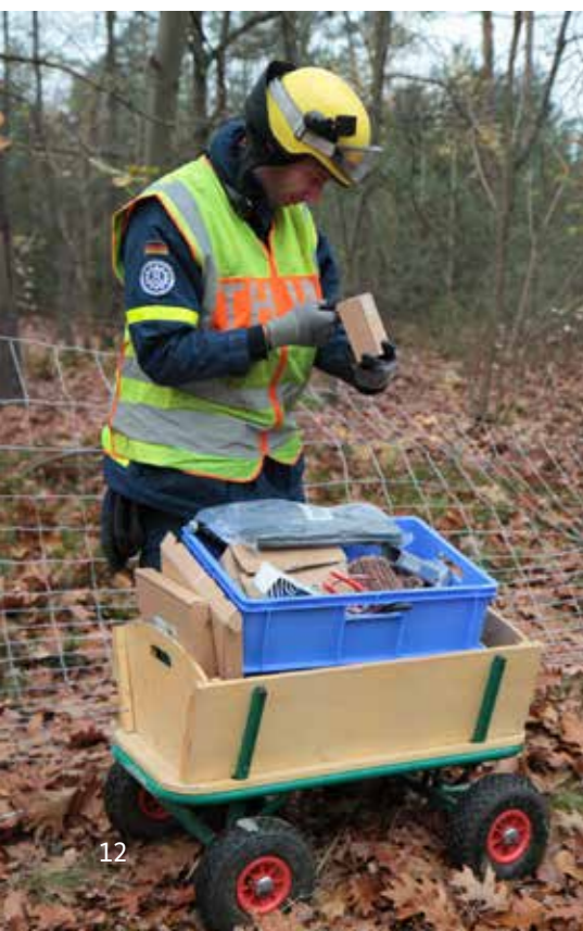
Einen 135 Kilometer langen Zaun bauten THW-Helferinnen und -Helfer entlang der Grenze zu Polen, um die Afrikanische Schweinepest zu stoppen. | THW volunteers erected a 135-kilometre fence along the border to Poland in order to prevent the African swine fever spreading.
